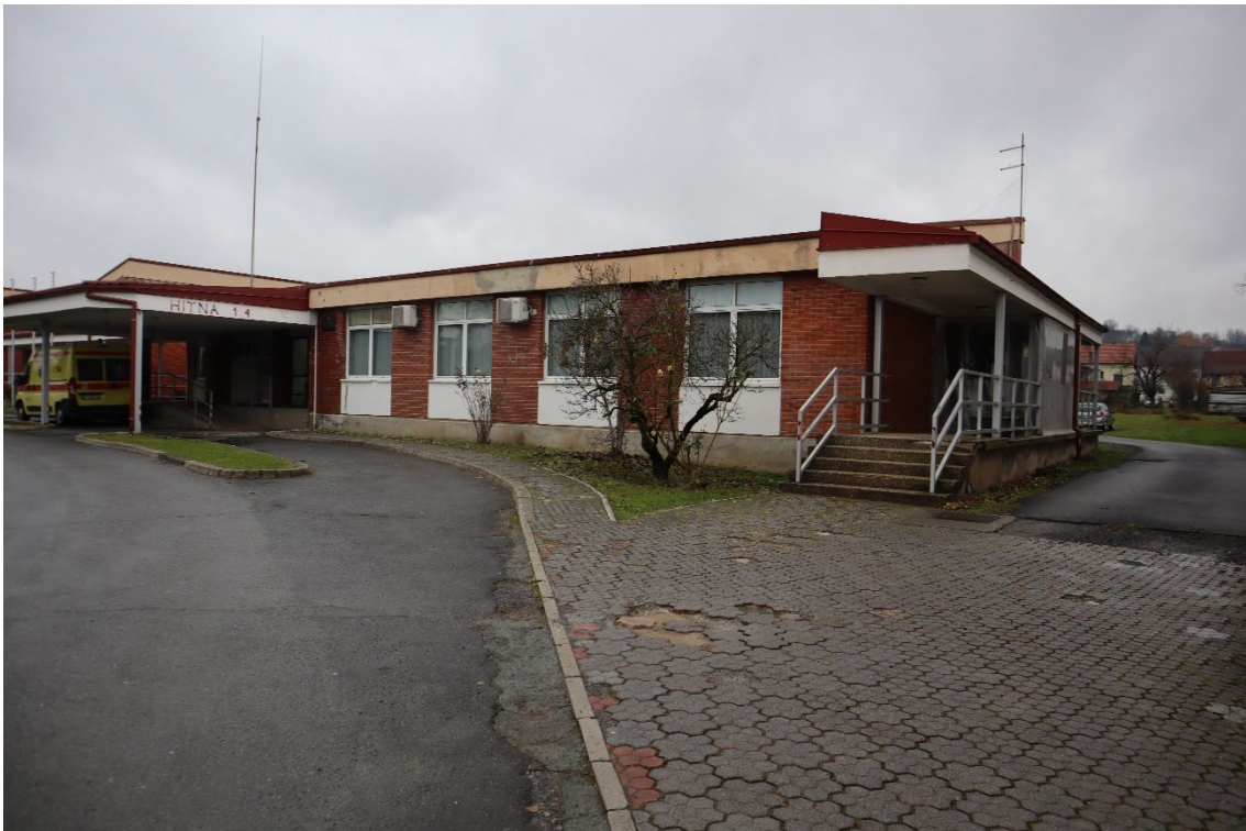
Slika 50 Prostori oko Doma zdravlja, dnevni centar za starije osobe (Autori: 3E PROJEKTI d.o.o. i Andlar)
